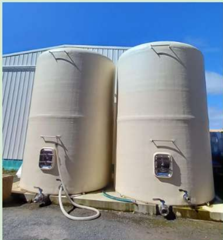
Cuves de récupération d'eau au Centre Technique Municipal
