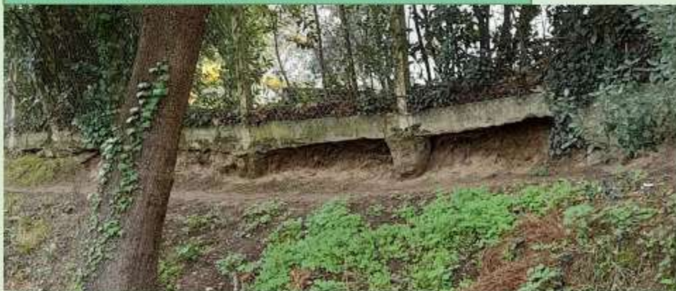
Le risque de glissement de terrain sur le cheminement
